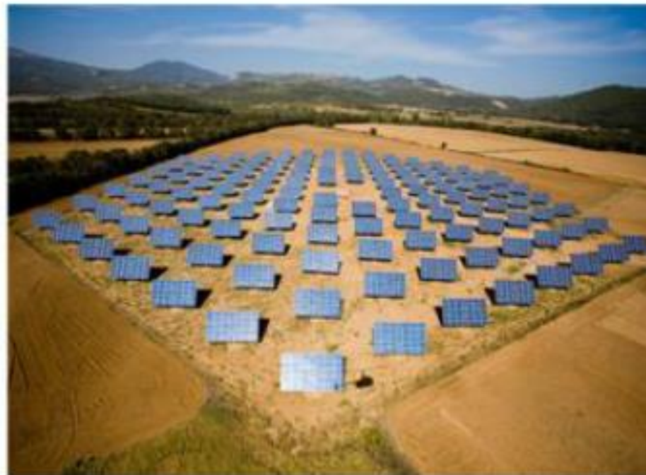
impianto a terra
